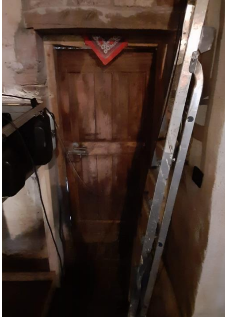
Afbeelding 6. Deur met slechte naad- en kierdichting
