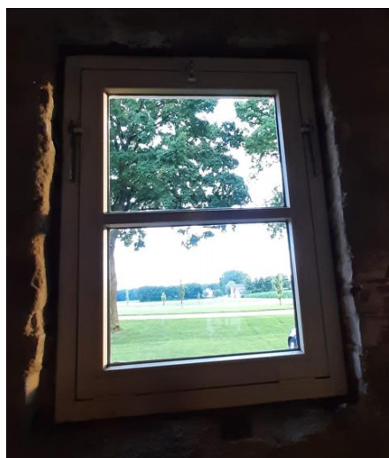
Afbeelding 5. Raam met slechte naad- en kierdichting
