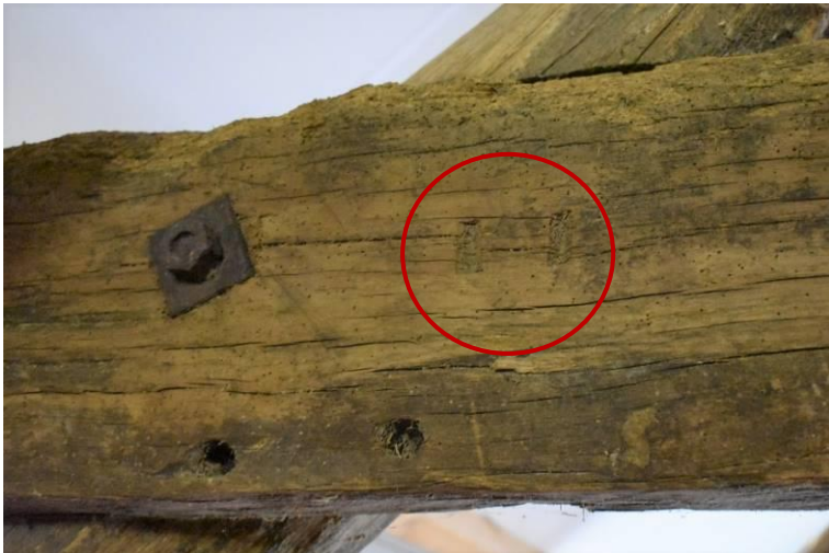
Telmerk II in een van de spanten. Tevens zijn sporen van een oudere pen-gatverbinding zichtbaar.
