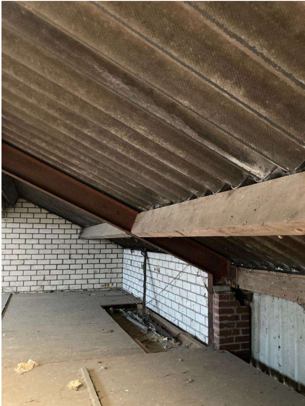
• Afbeelding 27: ongeïsoleerde golfplaten zolder
