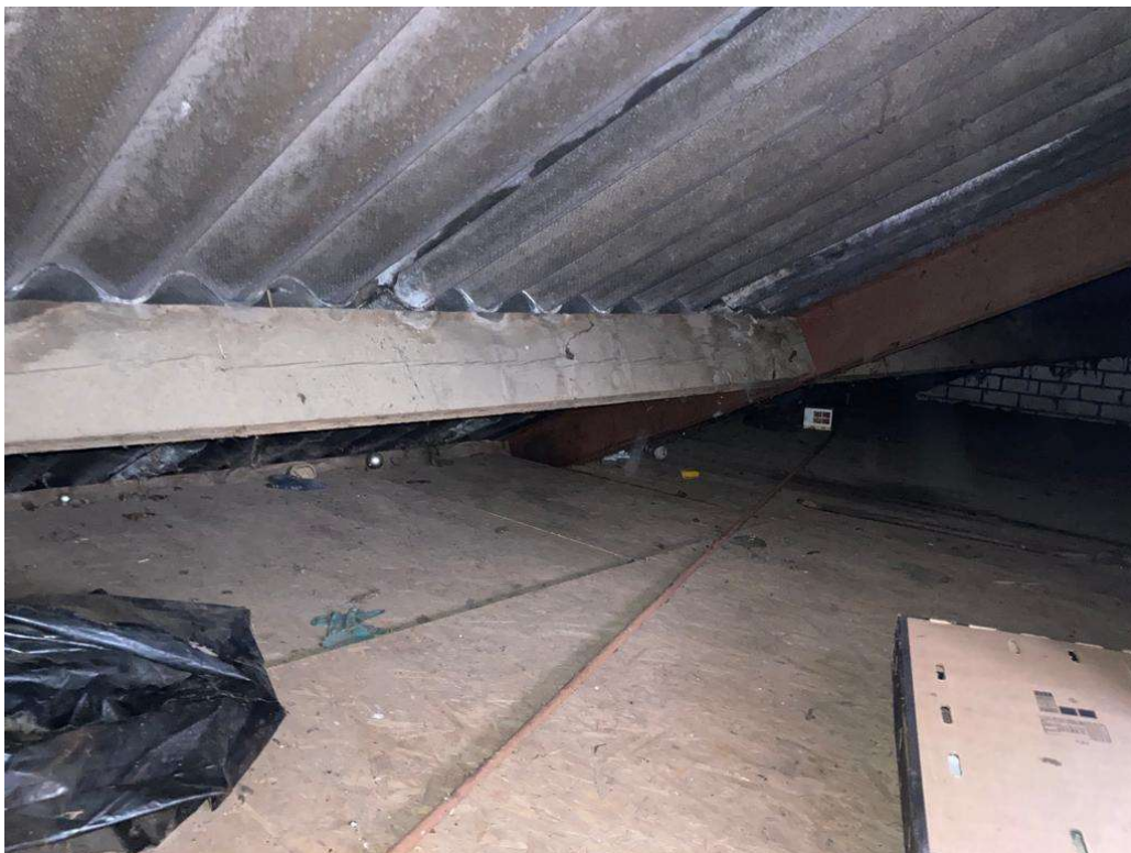
• Afbeelding 22: ongeïsoleerde golfplaten, zolder van schuur
