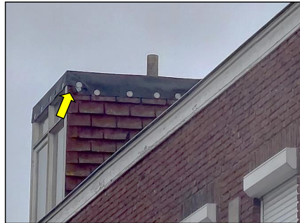
Figuur 18. Ruimte onder de loodflappen.
