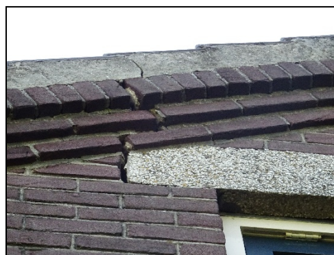
Figuur 9. Scheuren in de muur die toegang geven tot de spouwmuur.
