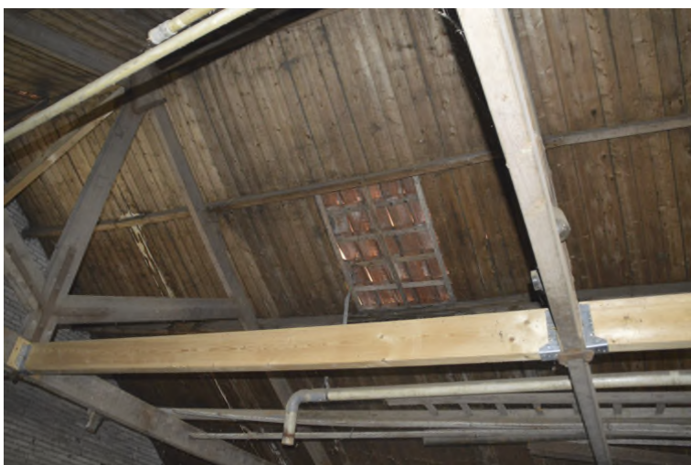
Binnenzijde schuur met kierend dakbeschoot
