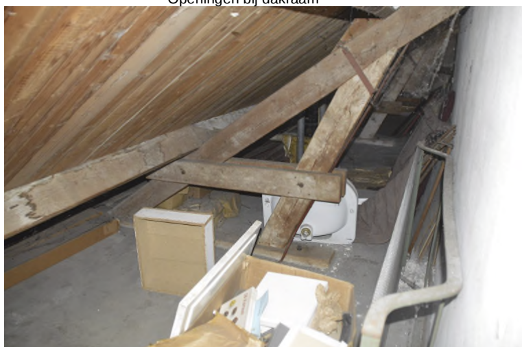
Zolderruimte met kierend dakbeschoot
