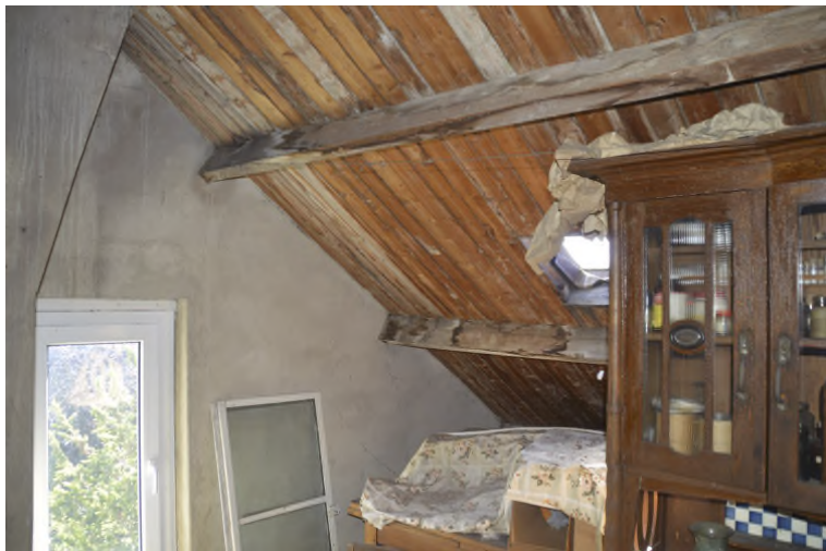
Binnenzijde woning met houten kierend dakbeschoot
