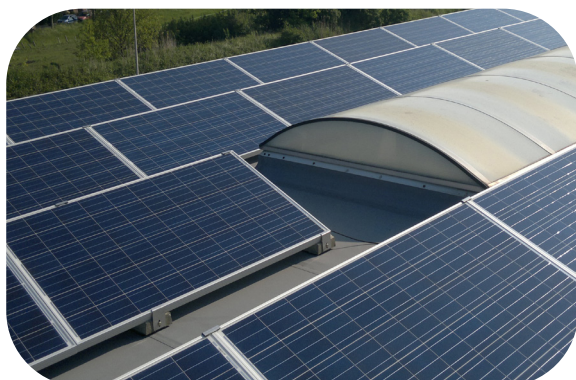
duurzame energie opwekking - zonnepanelen
