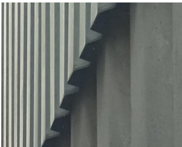
De damwandplaten betimmering staat te ver van de buitengevels.
