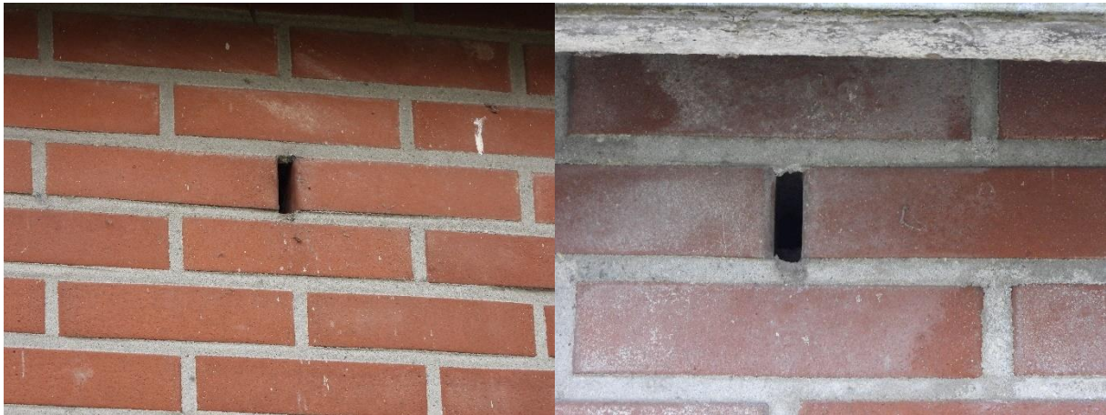
Open stootvoegen aangetroffen aan de gevels van de bebouwing.
