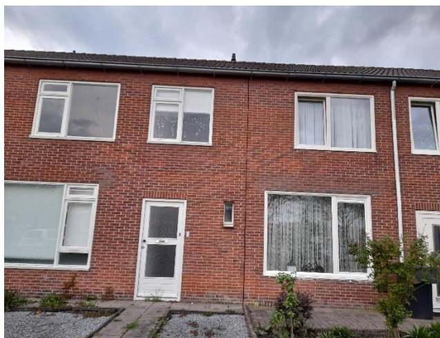
Figuur 4.1: Scheur in muur tussen woningen
