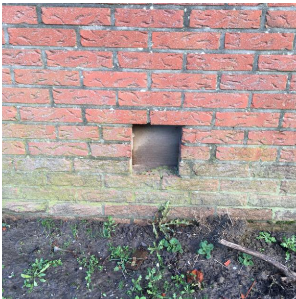
Figuur 4.2. Betimmering bij een gat in de gevel van de woning.
