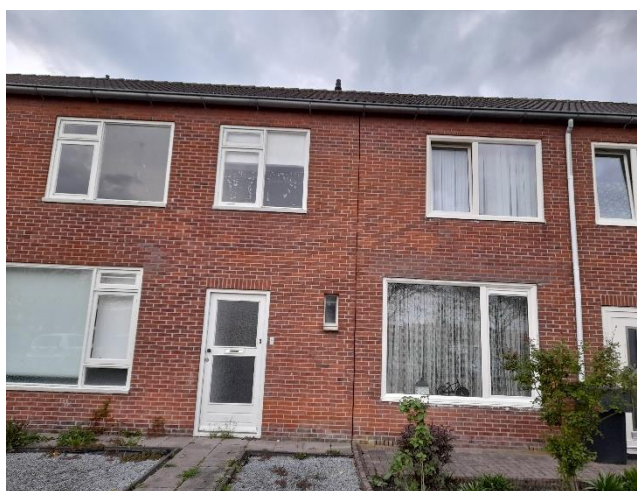
Figuur 4.1: Scheur in muur tussen woningen
