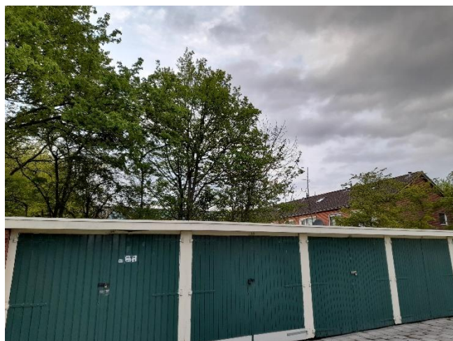
Figuur 4.5: Vochtige openingen in houten dak betimmering
