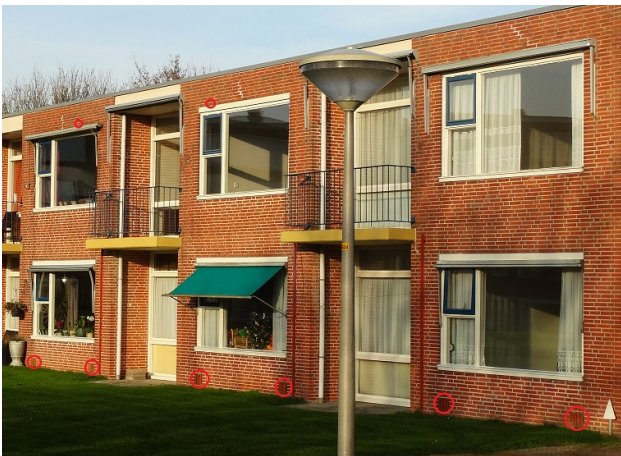
Figuur 22: Open stootvoegen onder- en bovenkant gebouw B.
