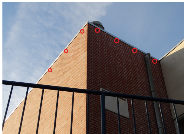
Figuur 18: Open stootvoegen onder de dakrand van gebouw A..
