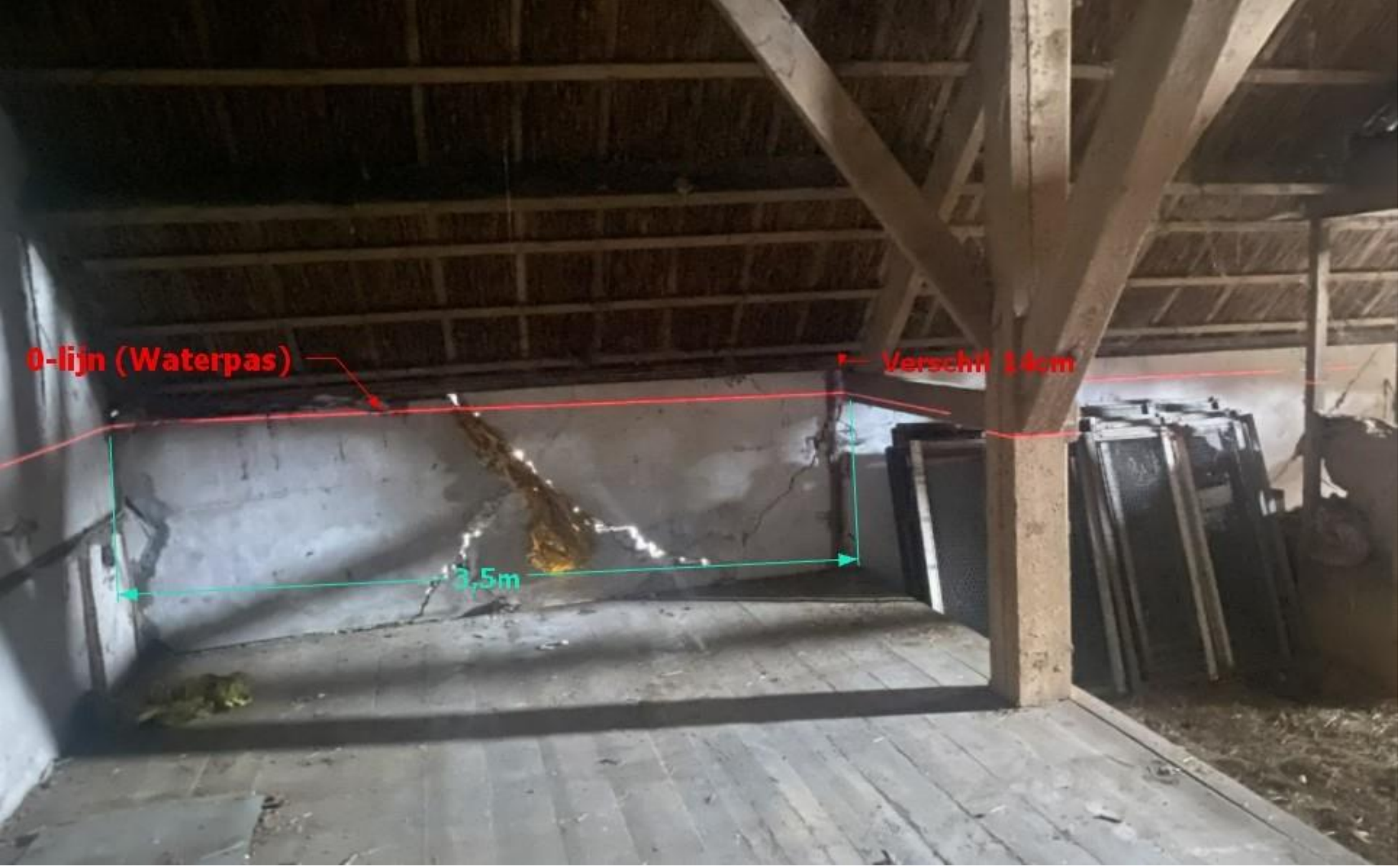
Hoogteverschil gevel t.h.v. de zoldervloer (westzijde)
