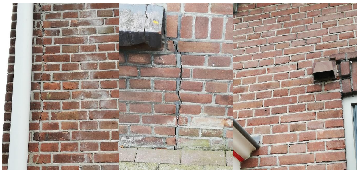
Afbeelding 3: Scheuren in gevels woning Lekdijk 384 Nieuw-Lekkerland
