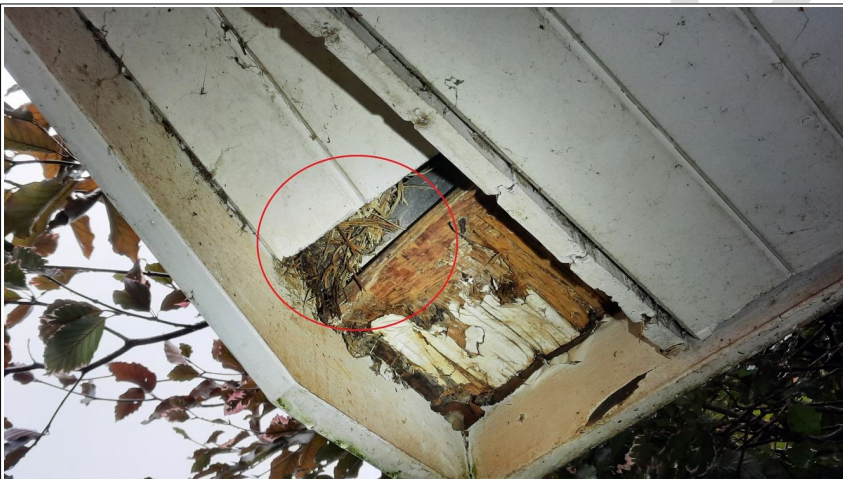
Afbeelding 9: Opening in de dakoverstek van het noordelijke deel van Zuidzijde 96. Aan de bovenzijde is nestmateriaal te zien van een potentieel huismusnest (rood omcirkeld). Foto: M.M. Bouwmeester | Ecoresult B.V.
