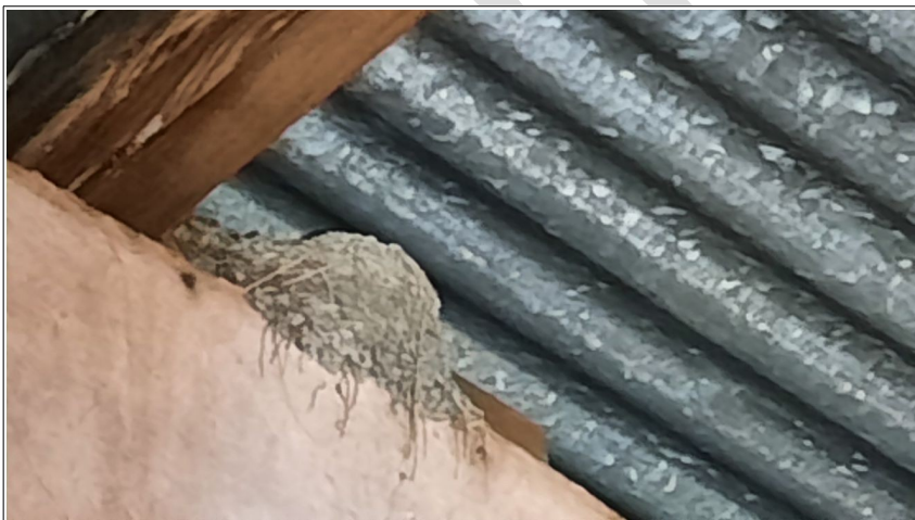
Afbeelding 10: Nest van boerenwaluw op een balk van de dakconstructie van de halfopen schuur. Foto: M.M. Bouwmeester | Ecoresult B.V.
