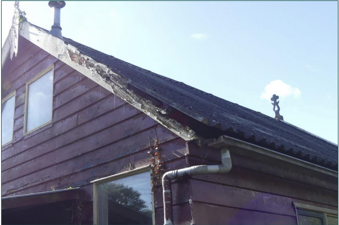
Figuur 3.2 Afgebroken/afgesleten overstek, welke mogelijk ruimte biedt tot de dakruimte.
