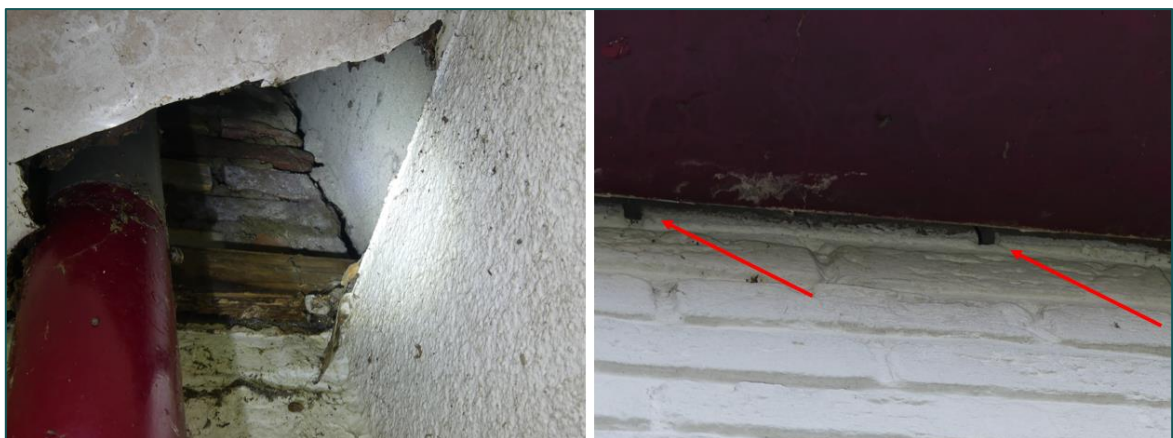
Figuur 3.3 Links: opening in het overstek. Rechts: Openingen onder de dakgoot.
