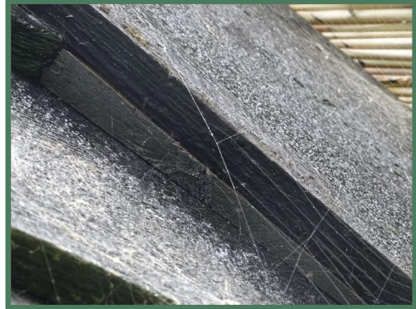
Gebrek aan ruimte bij overstekbetimmering
