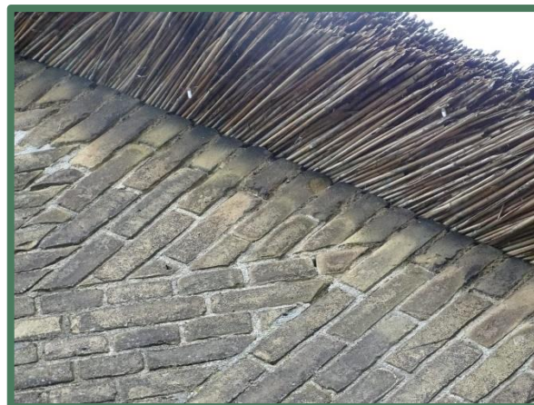
Gebrekk aan ruimte bij het bindriet
