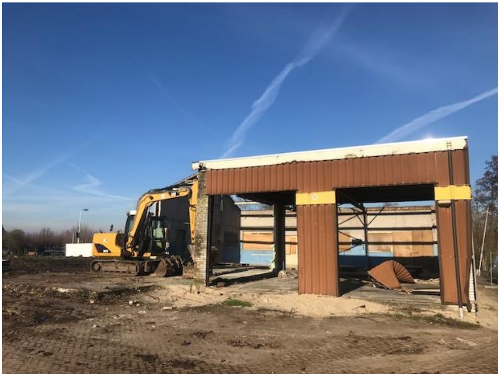
Figuur 4 Het gebouw aan de voorzijde van de planlocatie bestaat uit een gemetselde (spouw)muur, welke bekleed is met damwandplaten, met een dak geraamte. Enkele muren ontbreken net zoals de dakbedekking en dakbeschoot
