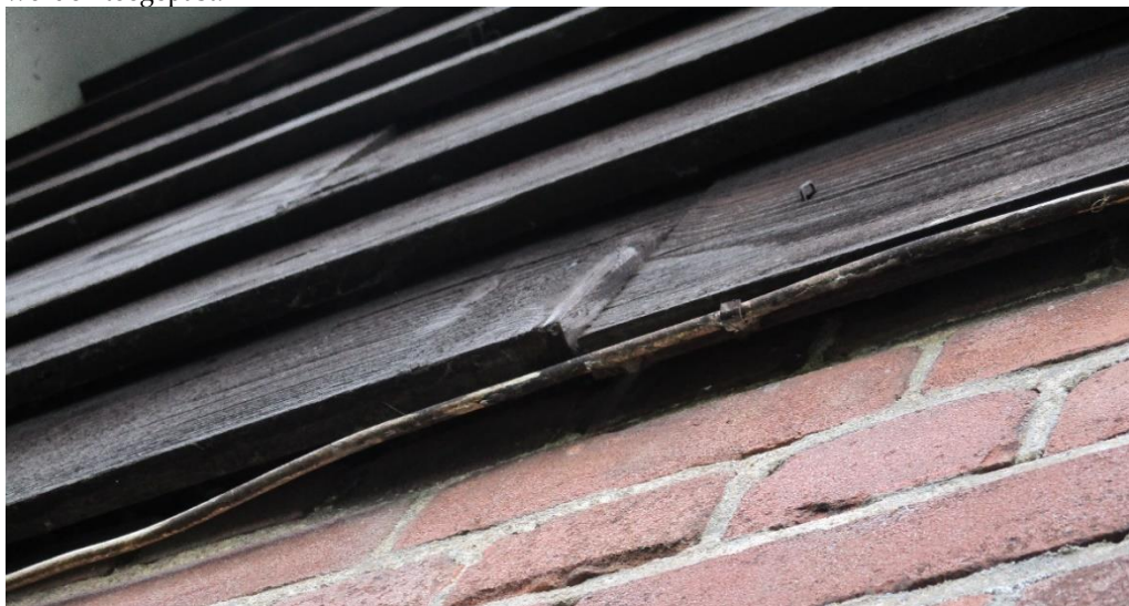
Figuur 3 De gepotdekselde planken aan de kopgevels van de woning C zijn over de gehele onderzijde open. Hierdoor is er geen stabiel microklimaat en is er geen geschikte vaste rust-of verblijfplaats voor vleermuizen. Het is wel mogelijk dat deze ruimte wordt gebruikt als tijdelijke rustplaats.
