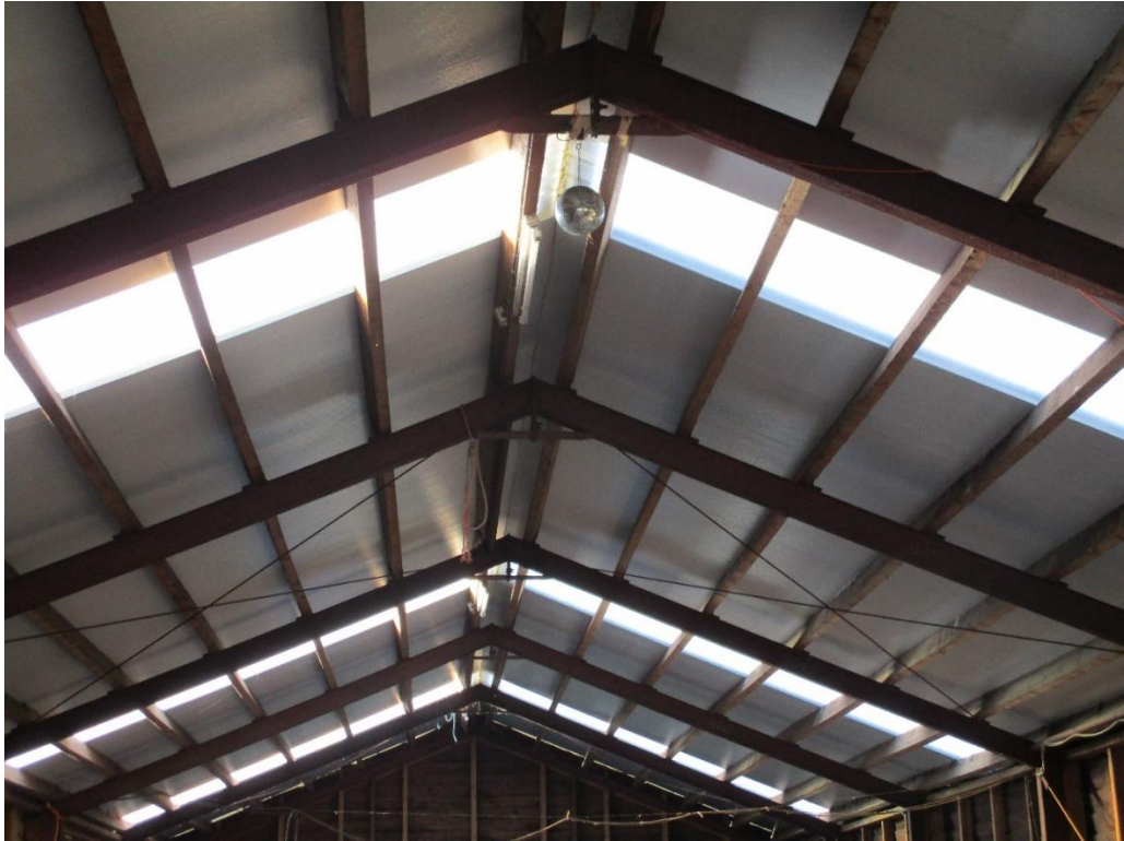
Figuur 3 Dakconstructie van de loods. Door het gebruik van damwandplaten en ontbreken van een dakbeschot is er geen broedgelegenheid voor huismussen.
