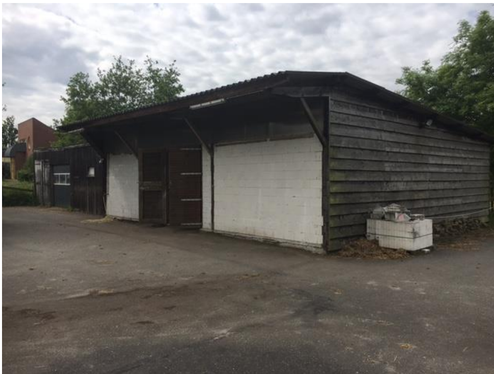
Afbeelding 6: Bestaande vervallen schuren
