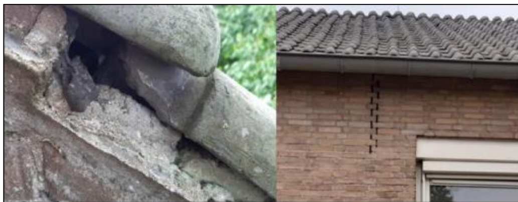
Figuur 1.3 Middels openingen bij de kantpannen, een scheur in de muur en dakpannen zonder dak toegankelijke dakgoten kunnen huismussen en vleermuizen het schoolgebouw betreden.
