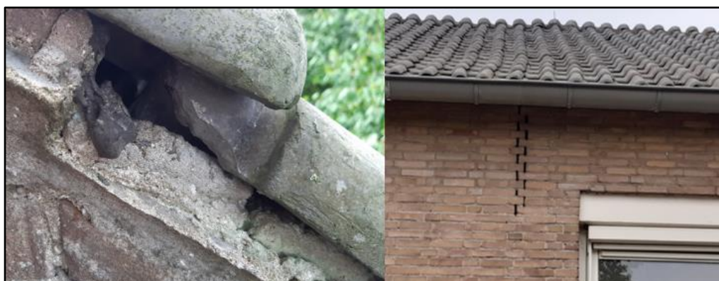
Figuur 4 Opening in bij de kantpannen en een scheur in de muur aan de zuidelijke zijgevel t.h.v het speelplein.
