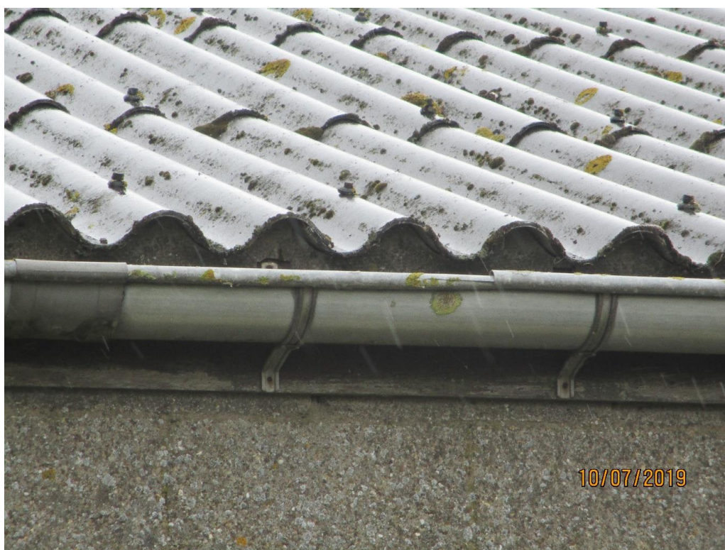
Figuur 4 De daken van de stallen en loods zijn ontoegankelijk voor huismussen.
