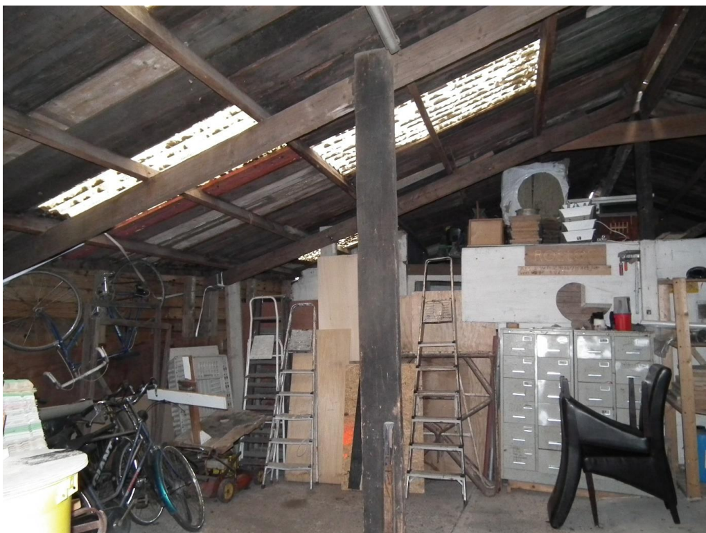
Figuur 2 De te saneren schuur heeft een golfplaten dak. Er is geen afwerking aanwezig als bijvoorbeeld dakbeschot.
