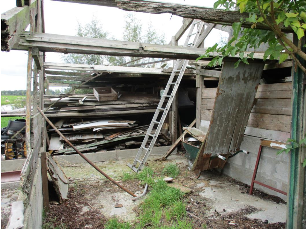
Figuur 3 De vervallen schuur aan de glazen plantenkas, slecht het frame hiervan is nog intact.
