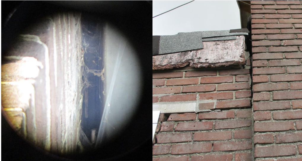
Figuur 5 Met links de ruimte tussen de muur en dakgoot met daartussen een houten schot en spinnen rag. En rechts de scheur tussen de woning en de aanbouw.
