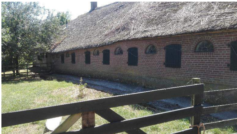
Figuur 2 De boerderij die gerenoveerd wordt bevat veel gaten en in het rieten dak.
