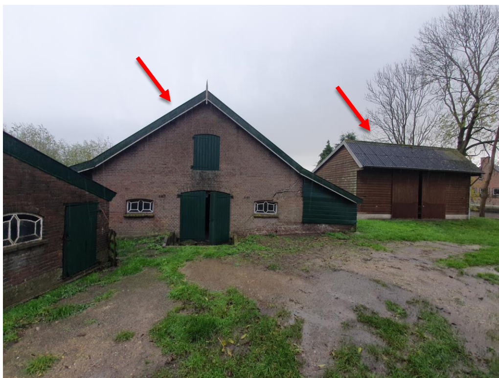
Figuur 2 De twee te saneren schuren, schuur B en schuur C. Schuur B is in zichtbaar verval met scheuren in de muren
