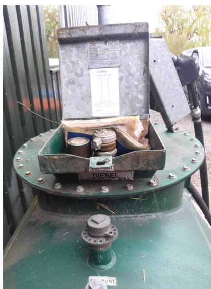
de bovengrondse tank
