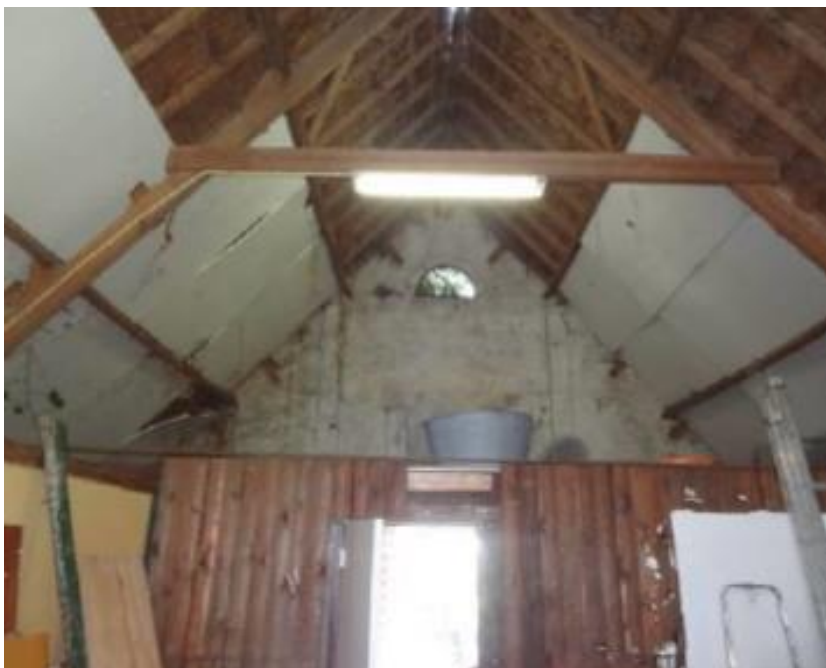
Afbeelding 5: Slechte bouwkundige staat varkensschuur
