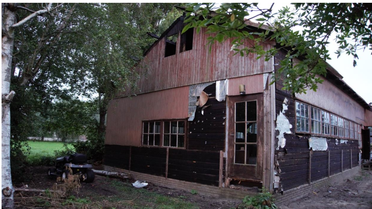
Figuur 4: Noordkant met zichtbare brandschade
