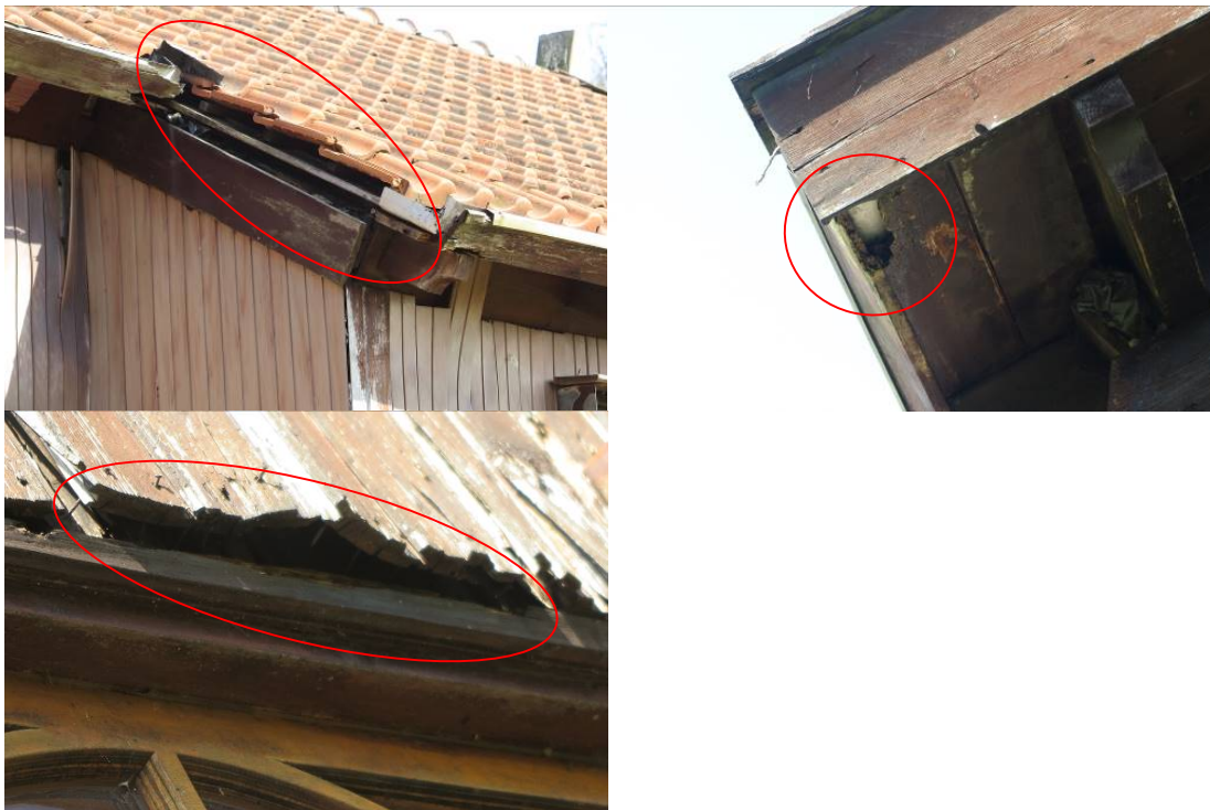
Figuur 4. Potentiële nest- / verblijfplaatsen van vleermuizen en gierzwaluwen in de opstal aan de Nieuwendijk 6-I te Noordeloos.
