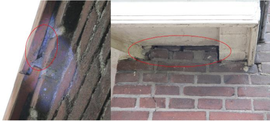
Figuur 4 Potentiële invliegopeningen voor vleermuizen onder de kantpannen in schuur B (links) en in scheuren in de woning (rechts).
