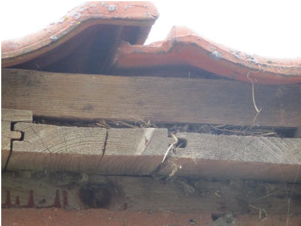
Figuur 6 Onder de dakpannen van schuur D was nestmateriaal duidelijk te zien.
