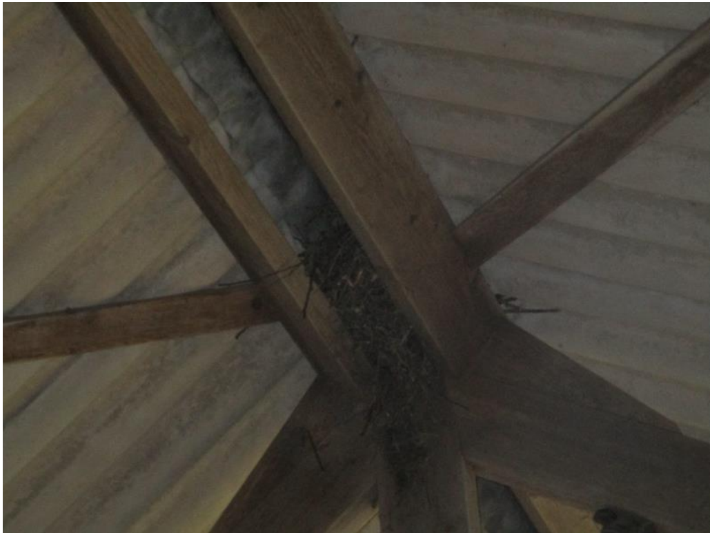
Figuur 4 In de dakconstructie van schuur A is een kauwennest aangetroffen
