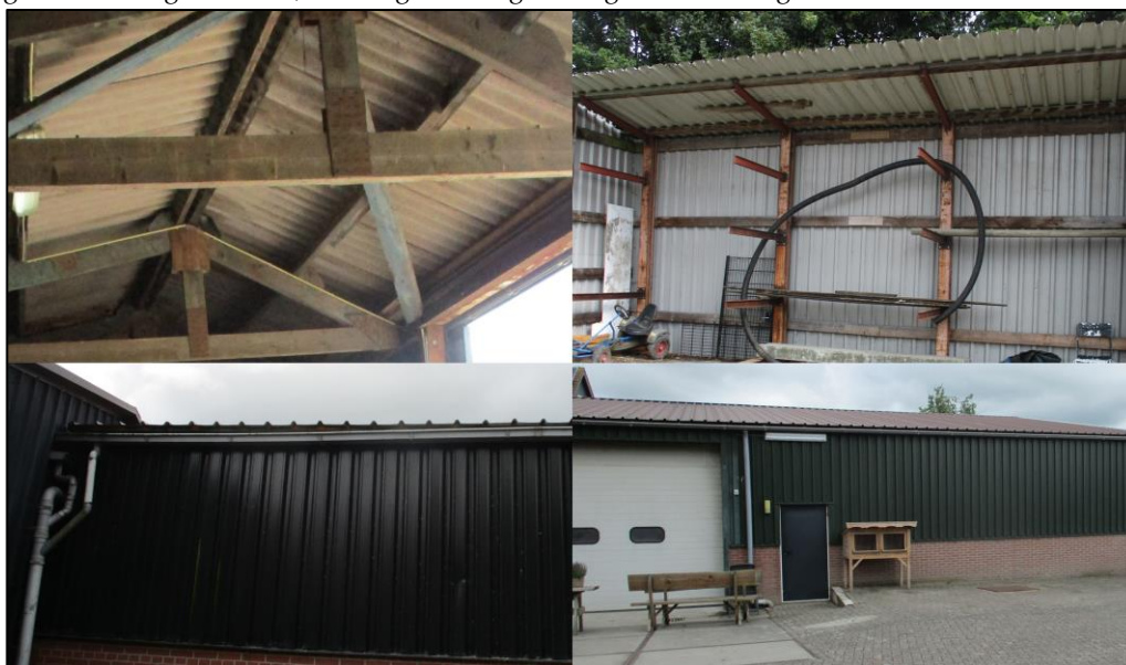
Figuur 5 Wegens de aanwezigheid van damwandplaten (onder), ontbreken van spouwmuren en dakbeschoot (boven), is de bebouwing (met uitzondering van de oostgevel van B) ongeschikt als rust- of verblijfplaats voor vleermuizen.
