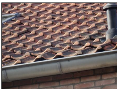
Figuur 35. Ruimte in de dakgoot en onder dakpannen.
