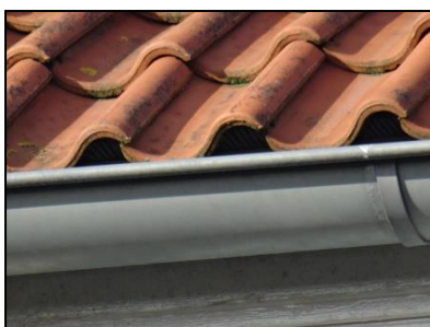
Figuur 39. Ruimte in de dakgoot en onder dakpannen.
