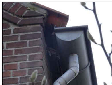
Figuur 38. Dakgoot op de kopse kant van de te renoveren woningen.
