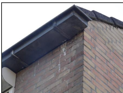
Figuur 13. Poepstrepen op de muur die aanduiden op een nestlocatie van de gierzwaluw.
