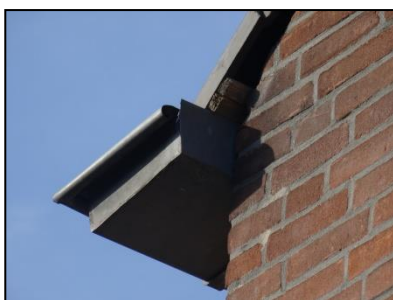
Figuur 5. Dakgoot op de kopse kant van de te renoveren woningen.
