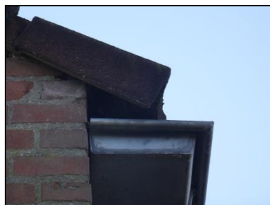
Figuur 18. Dakgoot op de kopse kant van de te renoveren woningen.
