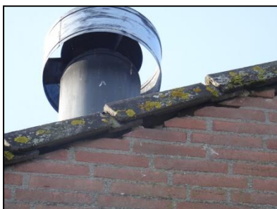
Figuur 19. Ruimte tussen de bakstenen muur en kantpannen.
