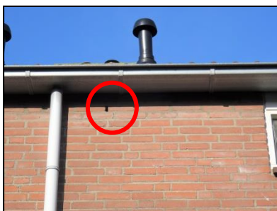
Figuur 25. Ventilatieopening onder de dakgoot.
