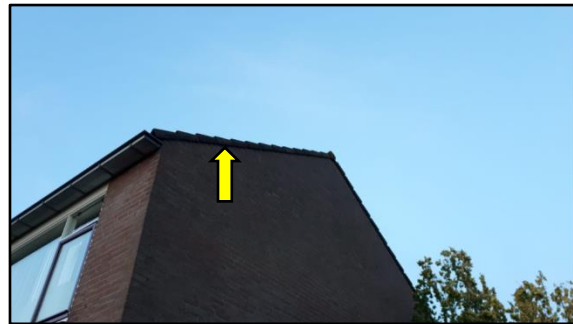
Figuur 9. Zomerverblijf van twee gewone dwergvleermuizen, Mercuriusstraat nr. 45. Het verblijf is aanwezig onder de gevelpannen (linkerzijde) van de kopgevel.
