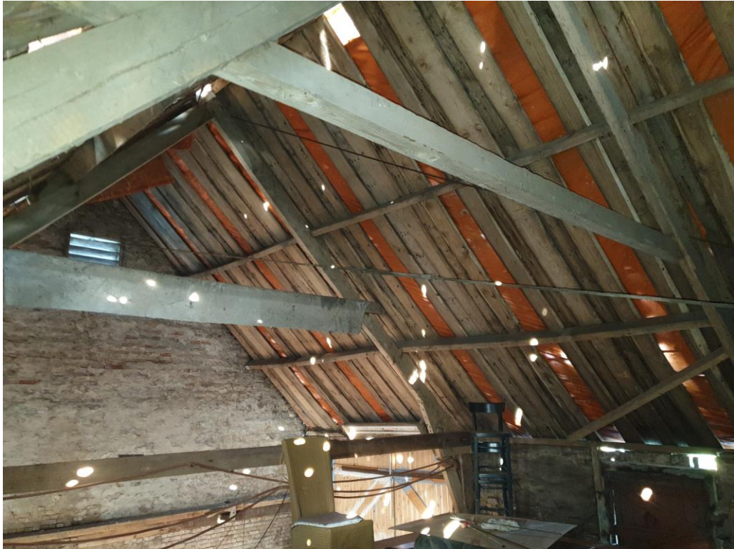
Figuur 3 De eerste schuur met zichtbaar geen ruimte onder de dakpannen voor nestlocaties.
