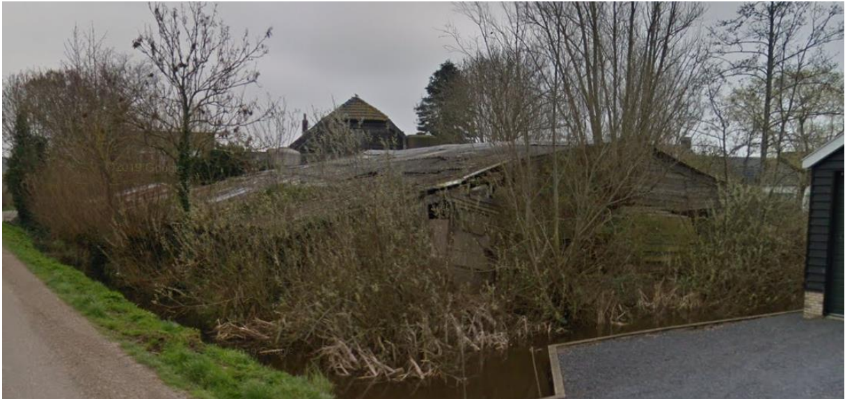
Afbeelding 7: In zeer deplorabele staat zijnde bijgebouw
