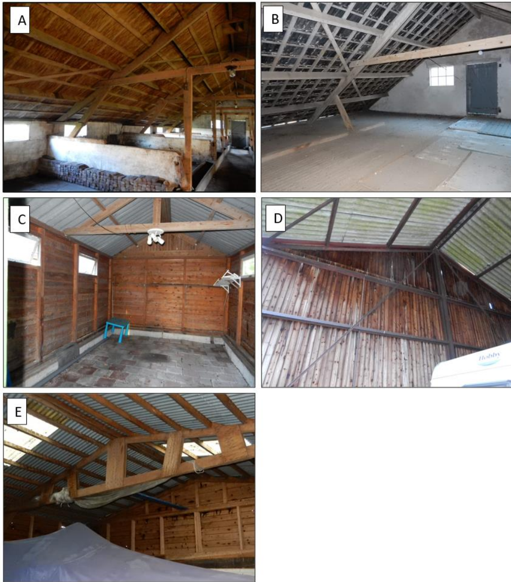
Figuur 4 Visuele representatie van de te saneren bijgebouwen. (A) de varkensstal. Riet is direct tegen de pannen bevestigd waardoor er geen nauwe ruimten in de dakconstructie aanwezig zijn. (B) de zolder van de koeienstal. (C) de garage. (D) de kapschuur. (E) de opslagschuur.
