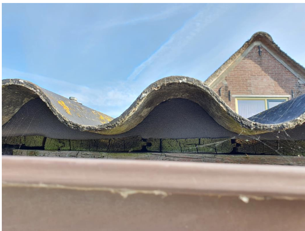
Figuur 2 De bebouwing is ongeschikt voor broedvogels onder de daken vanwege schuimrubber afdichting.
