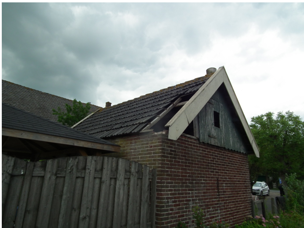
Figuur 4 Het bijgebouw verkeerd in een dermate verval staat dat delen van het dak en de gevels ontbreken. Tevens is het houtwerk aan de binnenzijde grotendeels verrot.
