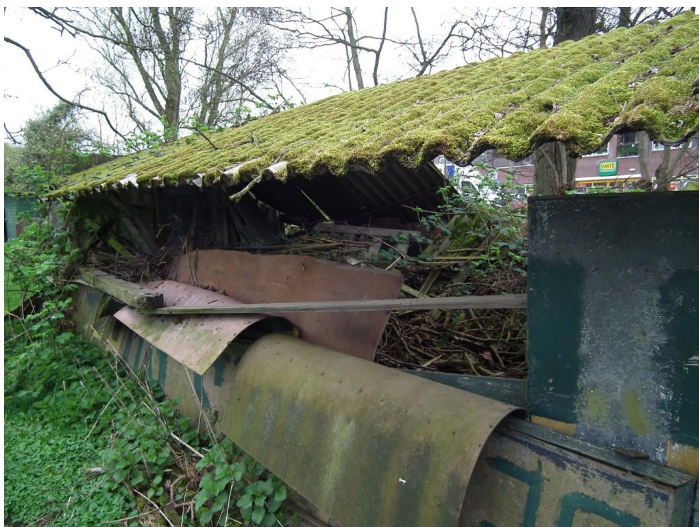
Figuur 2 Op de planlocatie zijn enkele schuurtjes aanwezig. Enkele van de schuurtjes verkeren in een zeer vervalende staat van onderhoud en zijn overwoekerd door braam.
