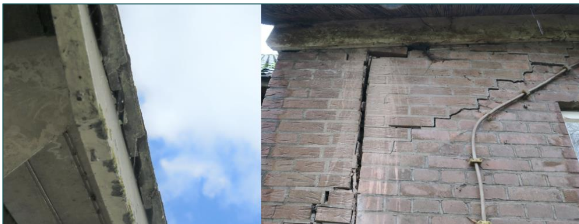
Figuur 3.1 De dakruimte van de boerderijwoning is toegankelijk middels kierende kantpannen (links). Scheuren in de muren geven toegang tot de luchtspouw en de binnenzijde van de schuur (rechts).
