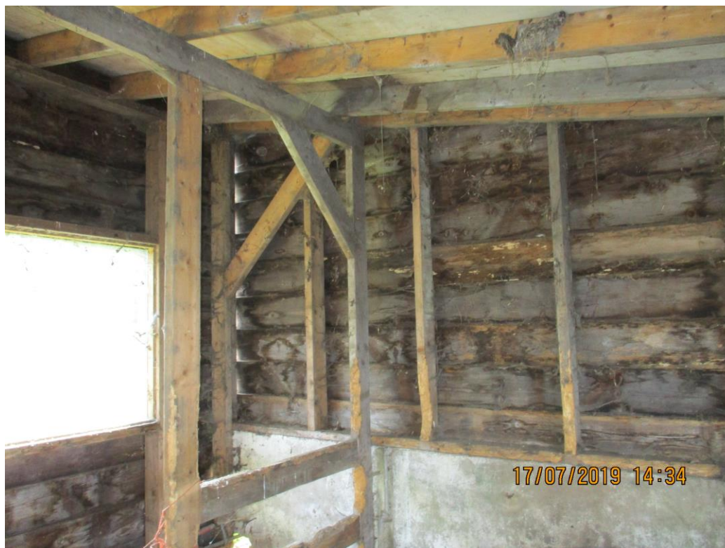
Figuur 2 Binnenkant van schuur B, zichtbaar dat er enkel laags hout aanwezig is en een spouw ontbreekt.
