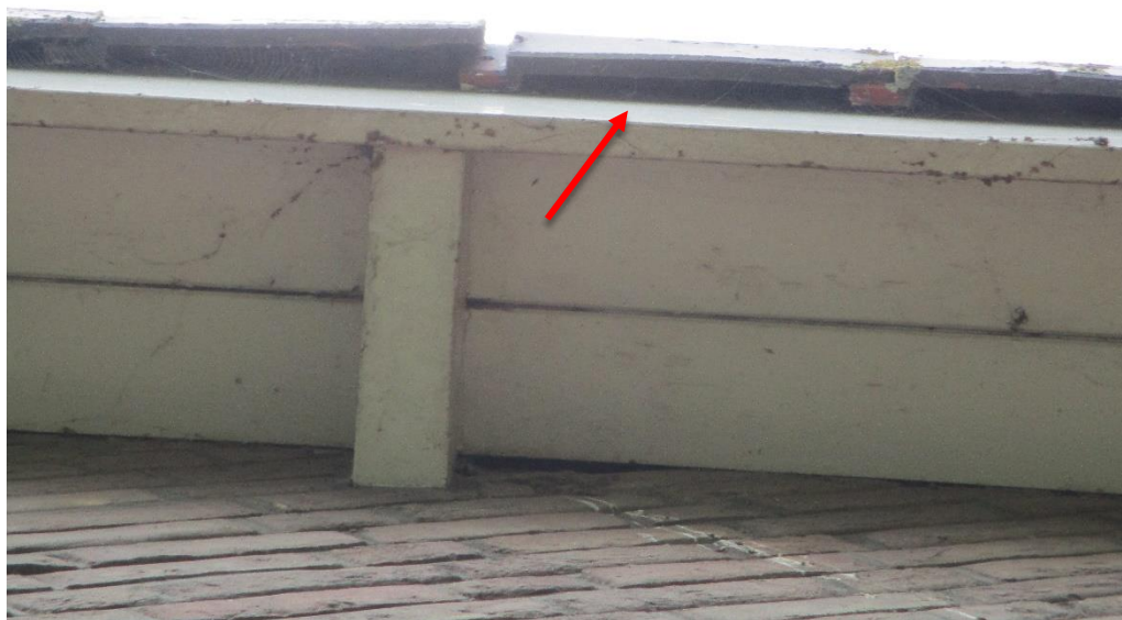
Figuur 4 Zichtbaar kierende kantpannen met voldoende ruimte om toegang te verlenen tot dak.
