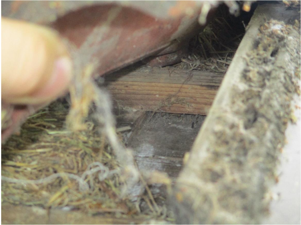
Figuur 3 Onder de dakpannen van de woning is nestmateriaal zichtbaar. Mogelijk kunnen hier actieve huismusnesten aanwezig zijn.
