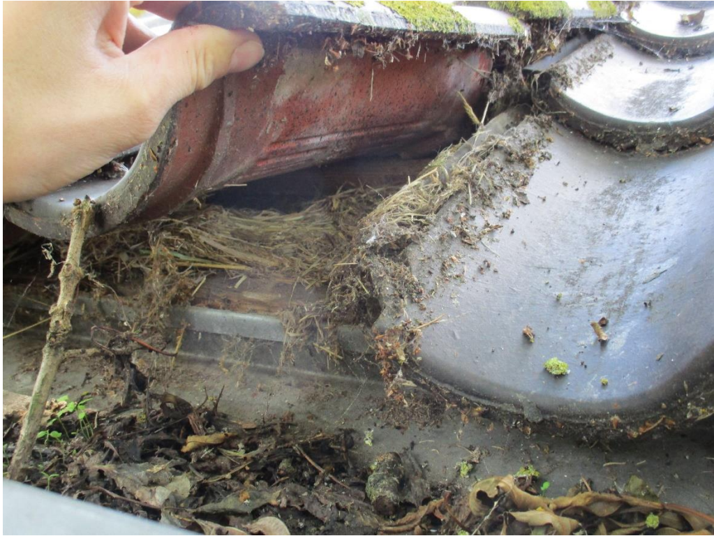
Figuur 5 Zichtbaar nestmateriaal onder een dakpan van de woning.
