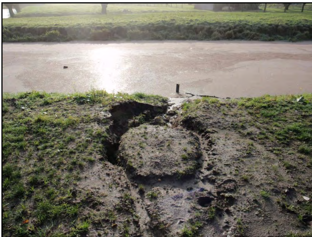
Figuur 9: Plaatselijk is de grond met zand opgehoogd of verstevigd. Dit is zichtbaar in het maaiveld en doordat delen de sloot in spoelen tijdens regenbuien.
