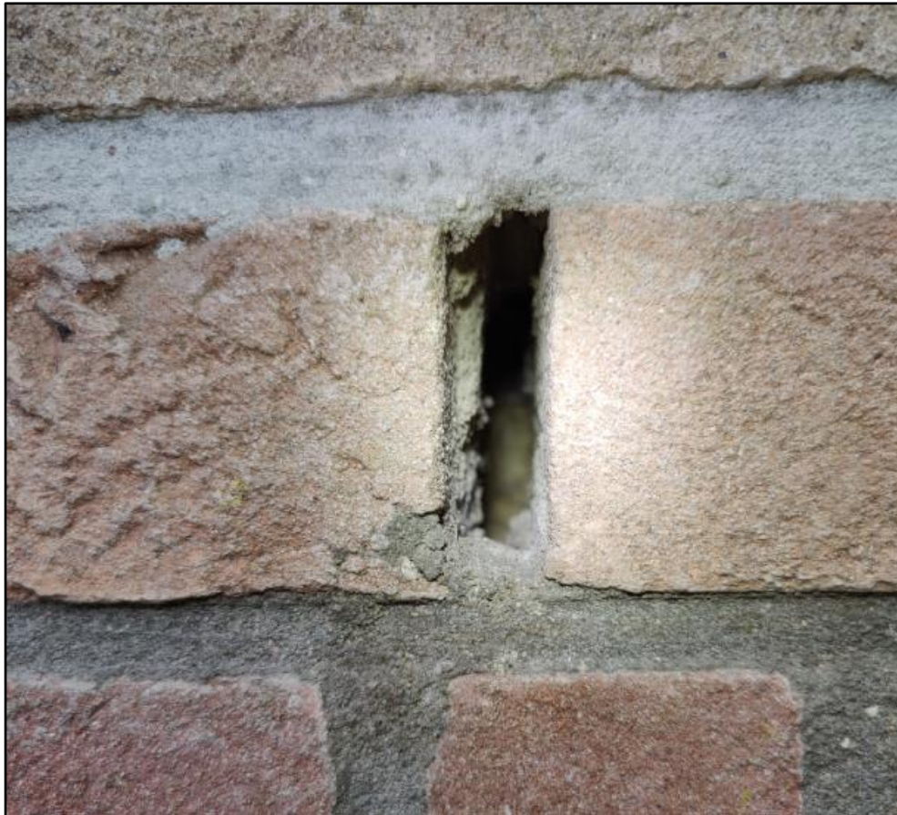
Figuur 2 Door de open stootvoegen is te zien dat er deels isolatiemateriaal aanwezig is in de spouwmuur. Er is echter een (beperkte) kruipruimte aanwezig.
