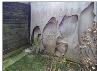
Figuur 8. Gebroken muur van een van de garages.
