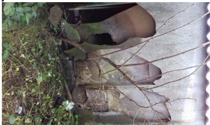
foto 18 - gedraaid [kapotte achtergevelplaat garage]
