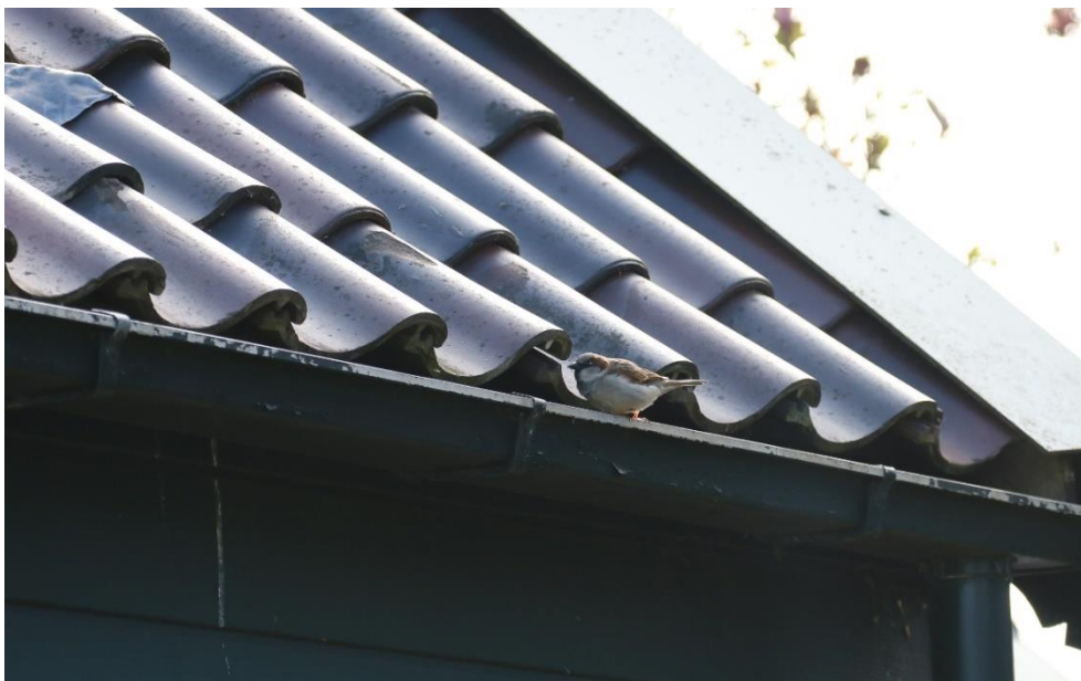
Figuur 14. In woning 307 zijn veel oude en in gebruik zijnde nesten van huismus aangetroffen. Deze bevinden zich onder de dakpannen, achter de dakgoot en achter de gevelbetimmering.
